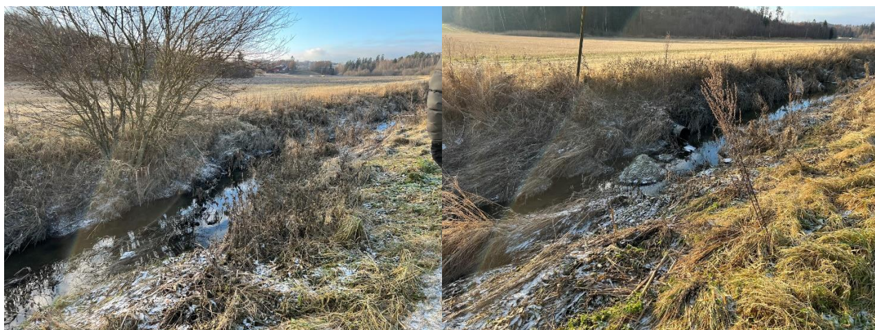
Figur 8. Venstre (7): Tre i bekkeløpet fører til erosjon, høyre (8): Utløp fra drenerør
