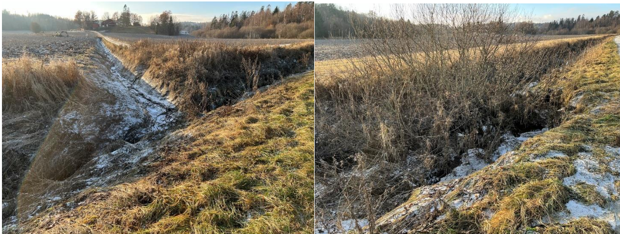
Figur 6. Venstre (5): nylig vedlikeholdt grøft på sørsiden av bekken, og høyre (6): tre midt i bekkeløpet skaper erosjon langs nordlig bredd
