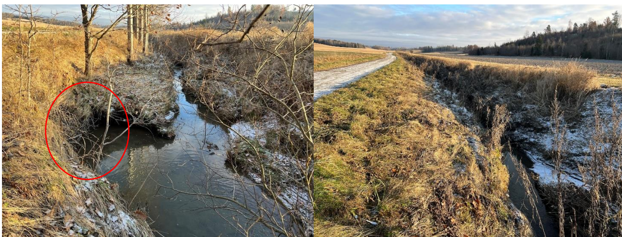
Figur 5: Venstre (3): utrasing langs nordsiden av bekken forårsaket av yttersving og drenerør, og høyre (4): starten på den kanaliserte strekningen med grusvei på nordsiden av bekken og jorder på sørsiden.
