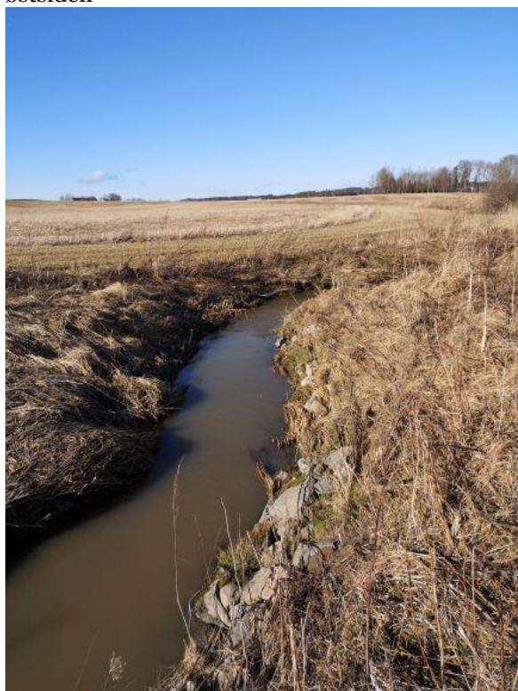
#7 Erosjon på vestsiden etter steinsatt sving på østsiden
