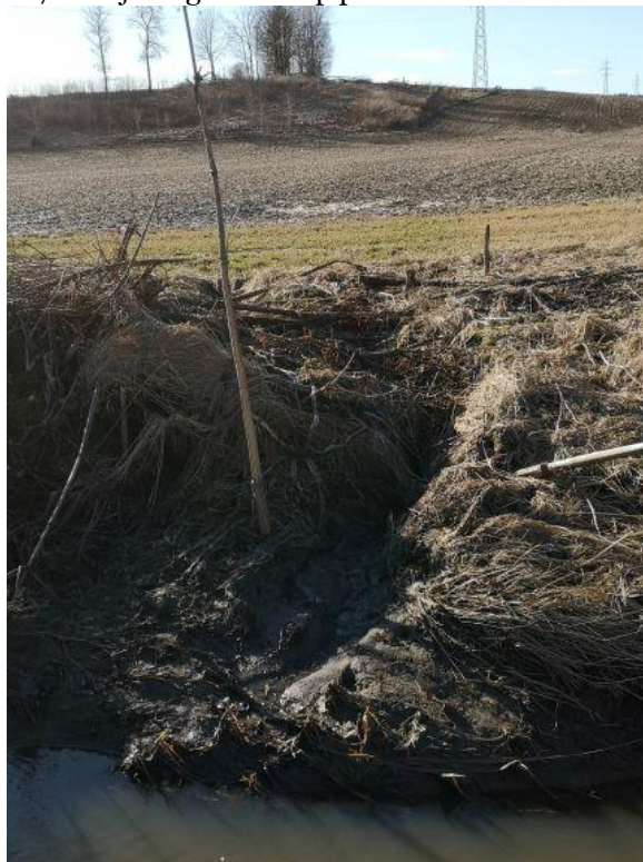
#17 Erosjon i grøfteutløp på vestsiden
