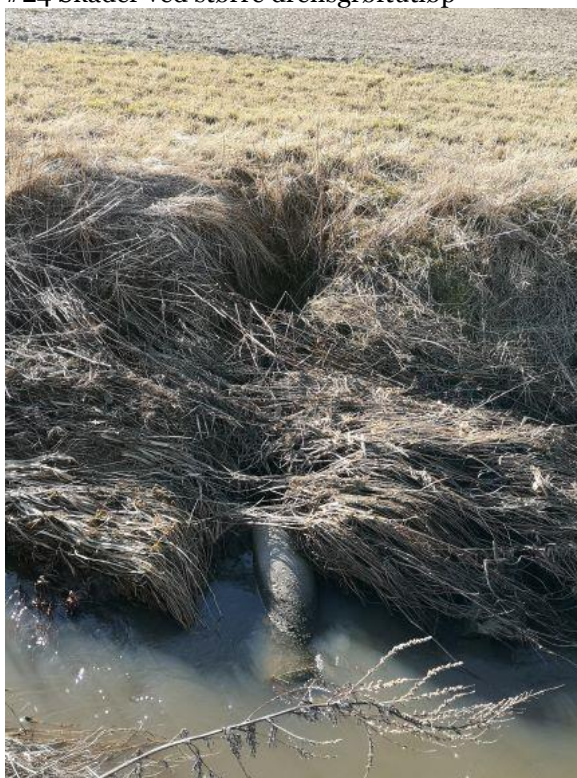
#24 Skader ved større drengroftutløp
