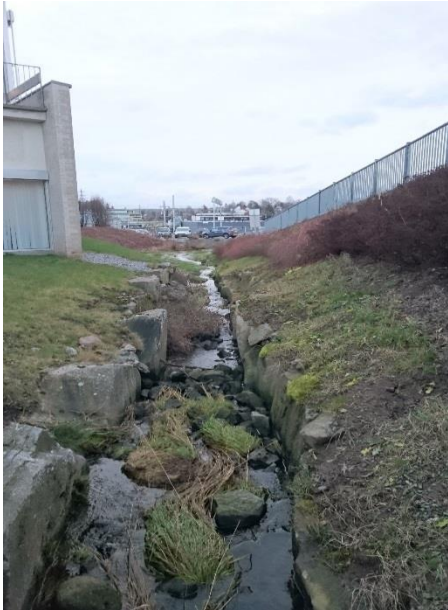
Bilde 2 Finstadbekken i åpen bekk/ kanal ved Follo tingrett. Tørrmur av stor sprengstein. Foto: Sweco
